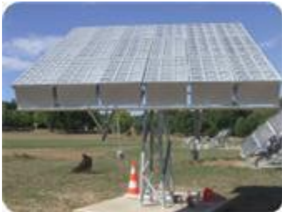
Photo : Une installation photovoltaïque à concentration (© CEA)
