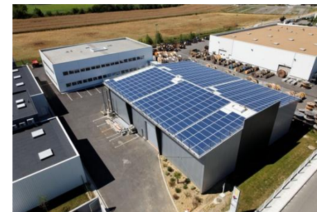
Photo : Panneaux photovoltaïques en toiture d'entrepôt (© Réalisation AJ Construction)
