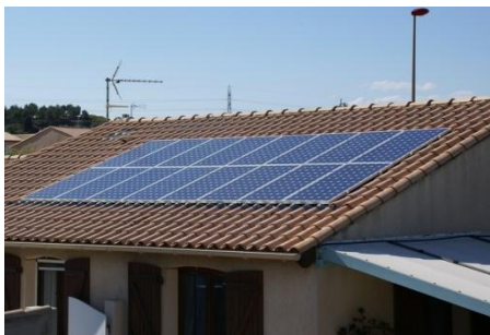
Photo : Panneaux photovoltaïques en toiture de maison (©GenSun SAS, www.gensun.fr)
