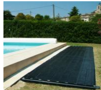
Photo : Panneau solaire pour le chauffage de piscine (© Giordano)
