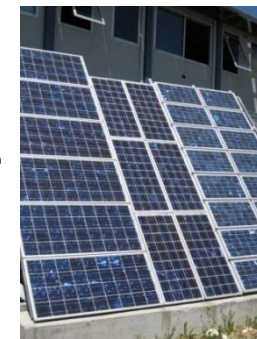
Photo : panneaux photovoltaïques (© E.De Lavergne/CEA)
